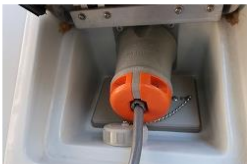
外部電源受電中
