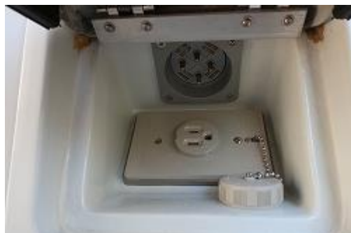
外部電源接続コネクタと発電機接続コンセント
