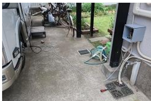
REX の発電機を接続した状態
