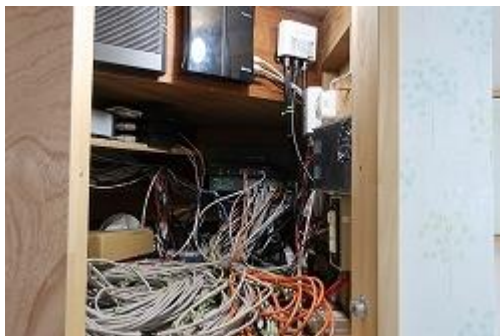
保安機器室内部
