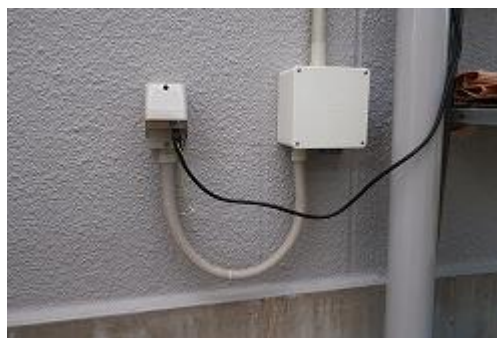
発電機接続箱 2
