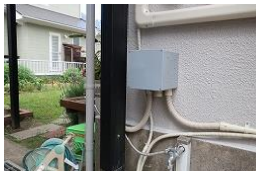
発電機接続箱 1
